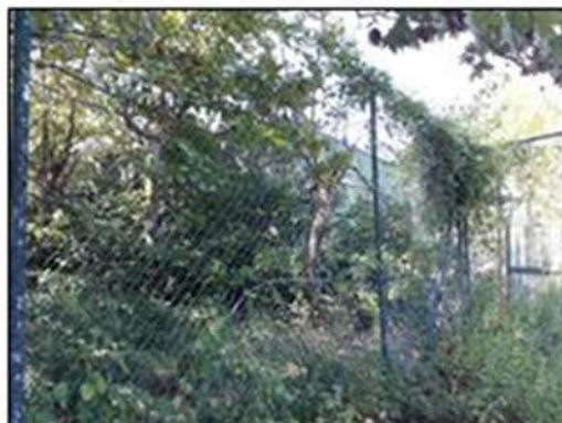
Fot 2 Recinzioni dei campi di tennis - stato attuale
