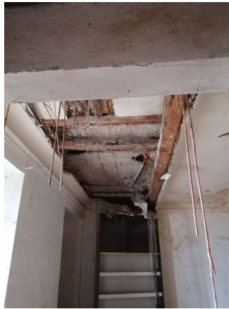
Elementi di degrado strutturale
