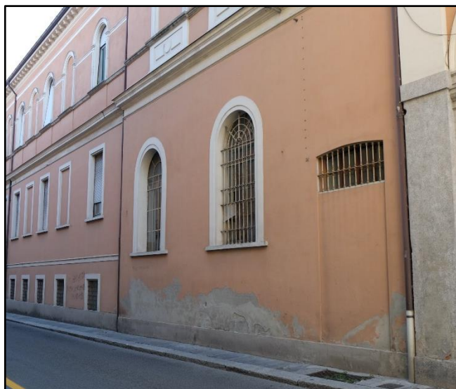
Degrado patrimonio edilizio pubblico
