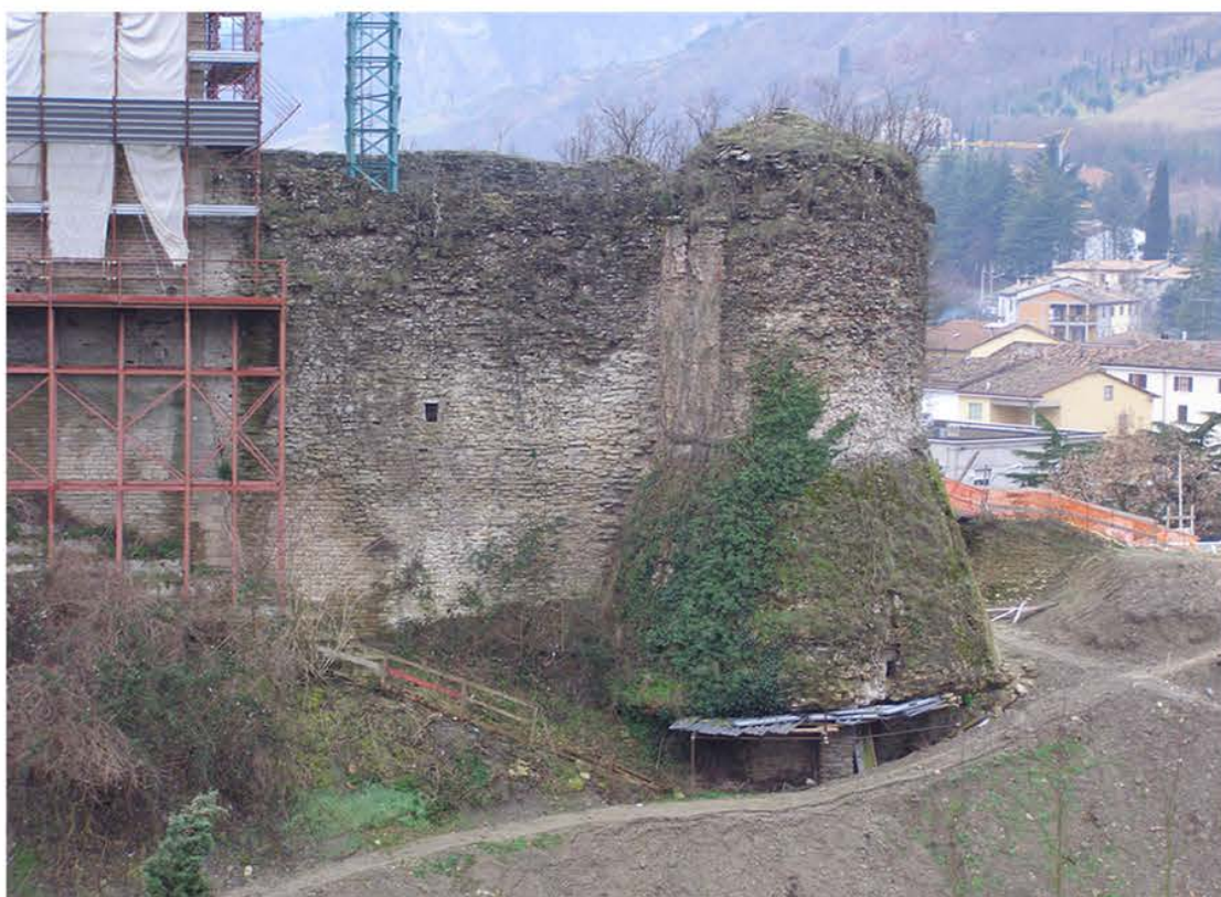
5° STRALCIO Interventi di sottofondazione della torre circolare Nord e di realizzazione del percorso pedonale attiguo
