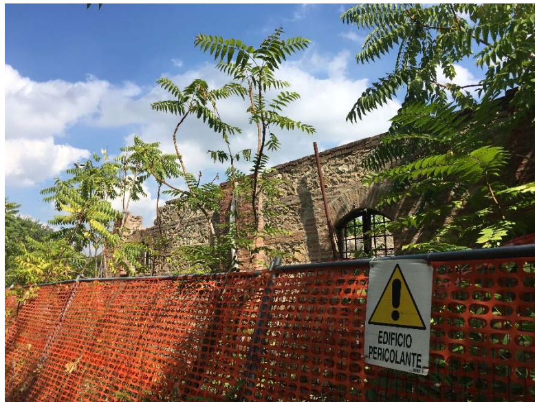
Fabbricati pericolanti e quasi interamente crollati
