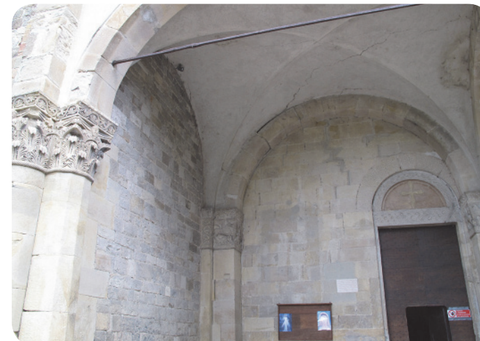
2 . Particolare del pronao della Abbazia di San Basilio (in fase di restauro).
