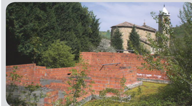
3. vestigia dei lavori avviati (e sospesi) nel lotto alle spalle della chiesa.
