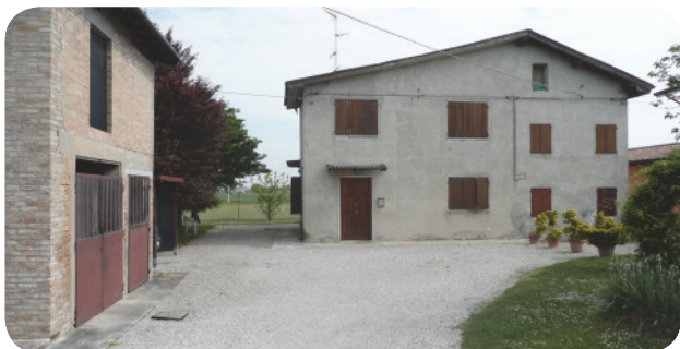
13. ristrutturazione di abitazione dalla tipica morfologia a falde asimetriche; sono evidenti diverse scelte incongrue, sia dal punto di vista compositivo che materico.
