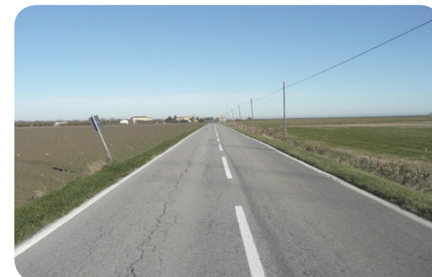
2. Proseguimento dell'argine Agosta (strada principale) all'interno dell'area bonificata di Valle Mantello (a destra e a sinistra della via).
