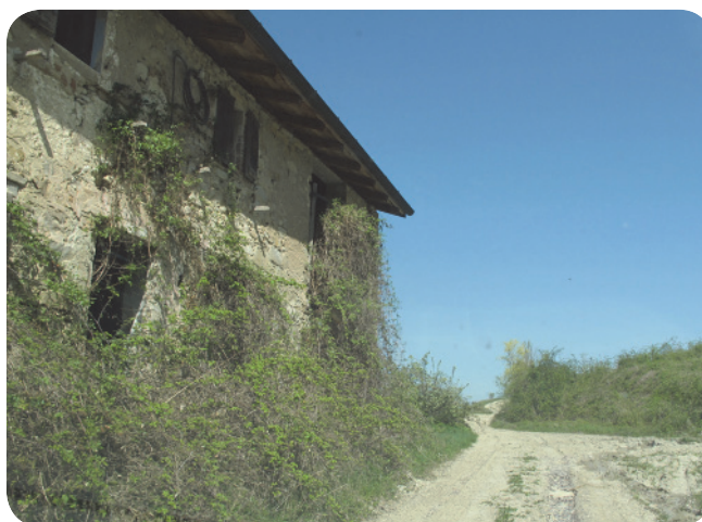
2 . L'edilizia rurale di Carfico, in stato di significativo degrado e di abbandono.
