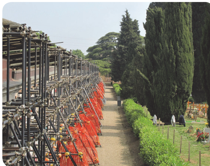
1 . Percorrendo il sentiero tangente all'ala inagibile del cimitero di Imola (puntellata per evitare ulteriori crolli), sullo sfondo si vedono due chiome di cedri del Libano.
