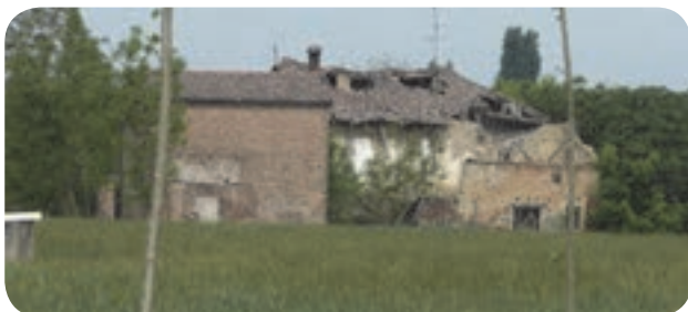
15. casa ciapadora con evidenti crolli strutturali. Talvolta non si ristruttura l'abitazione tipica per poter acquisire la volumetria necessaria alla costruzione di nuovi edifici.
