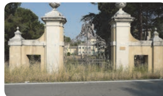
4 . L'immagine sottolinea ulteriormente la conflittualità del rapporto tra strada principale e ingresso monumentale (posto oggi a una quota molto inferiore al livello strada).
