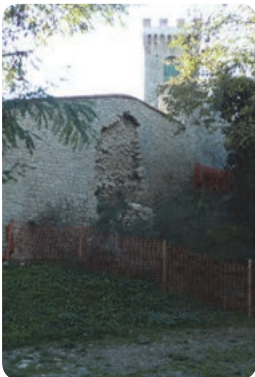
11 . Vista della parete nord della cinta muraria del castello al tempo della breccia (tra gennaio e dicembre 2010).
