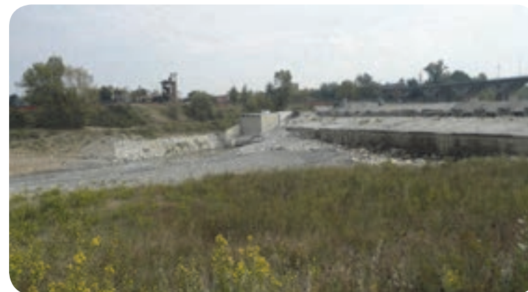
12 . Briglia del Ponte Veggia (nel tratto del Secchia a nord del perimetro del bene paesaggistico).
