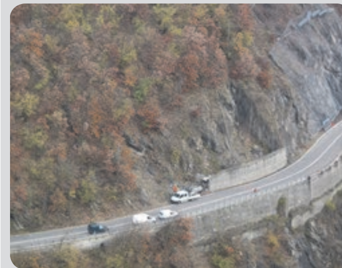
6. interventi di messa in sicurezza in un tratto della SS45 interessato dalla caduta di massi.
