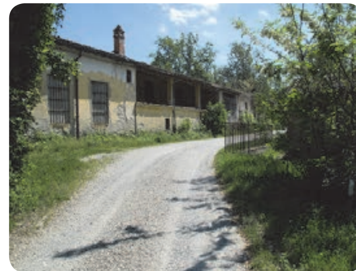
2 . Casino dei Boschi. Il corpo laterale, che versa in uno stato di avanzato degrado.
