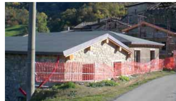
Fig. 36: No. Soluzione per la protezione delle falde impropria per le dimensioni eccessive della scossalina in rame e delle terzere.
