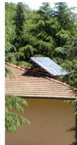
Fig. 120: No. Evitare impianti non integrati.
