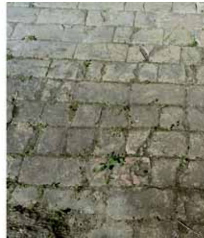
Fig. 96: Si. Pavimentazione tradizionale di un'aia, con mattoni per il verso piatto, senza malte.
