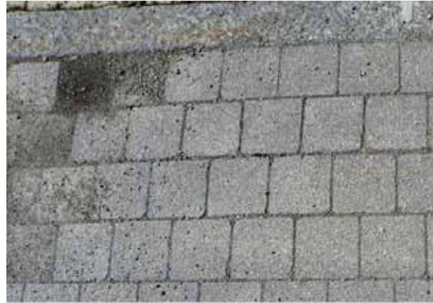
Fig. 111: No. Pavimentazione autobloccante non legata alle tradizioni locali.
