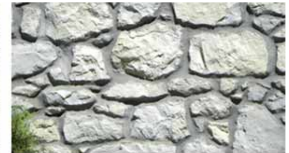
Fig. 47: Impiego improprio di malte cementizie.
