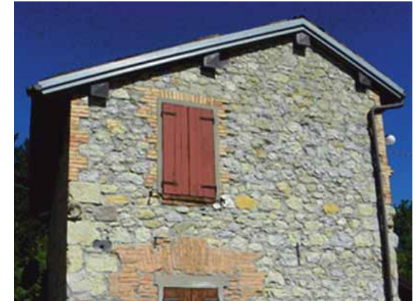
Fig. 45: Impiego improprio di malte cementizie.
