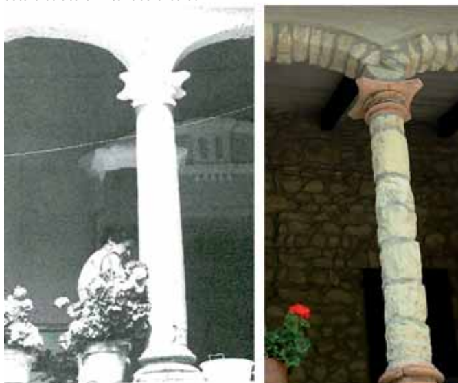
Fig. 58-59: No. Intervento incongruo di rimozione dell'intonaco che cancella una scelta stilistica storica, mette in evidenza i difetti costruttivi della colonna e le sottrae un elemento di protezione dagli agenti atmosferici.
