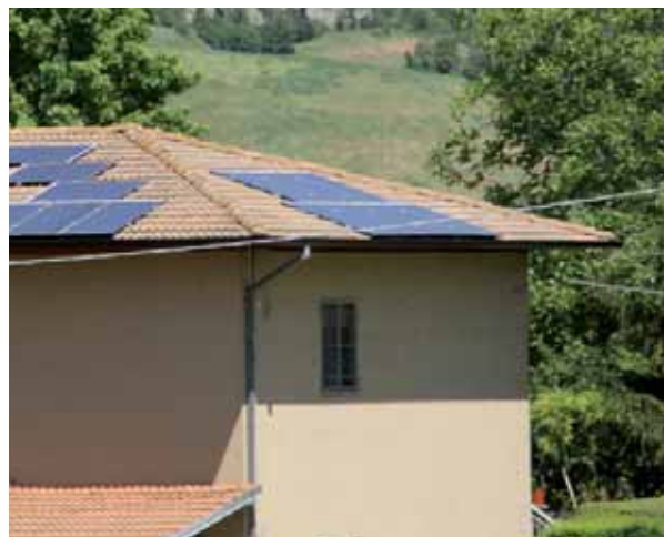
Fig. 119: No. Distribuzione frammentaria e disordinata degli impianti fotovoltaici sulla copertura.
