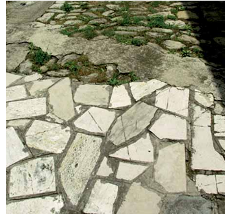
Fig. 113: No. Pavimentazioni tra loro non collegate e di cui la prima incongrua.
