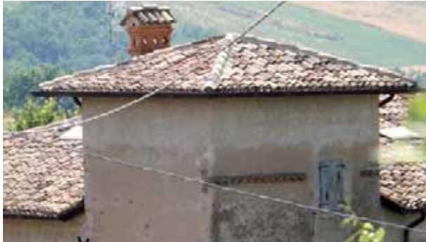
Fig. 37: No. Torre con tetto ad ombrello. Si notano l'impropria riduzione della pendenza delle falde del tetto e l'accentuazione eccessiva dello sporto di gronda.
