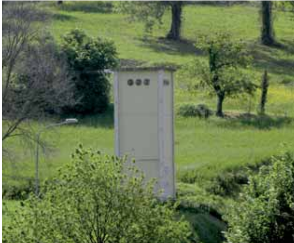
Fig. 123: Sì. Cabina con fili elettrici interrati.
