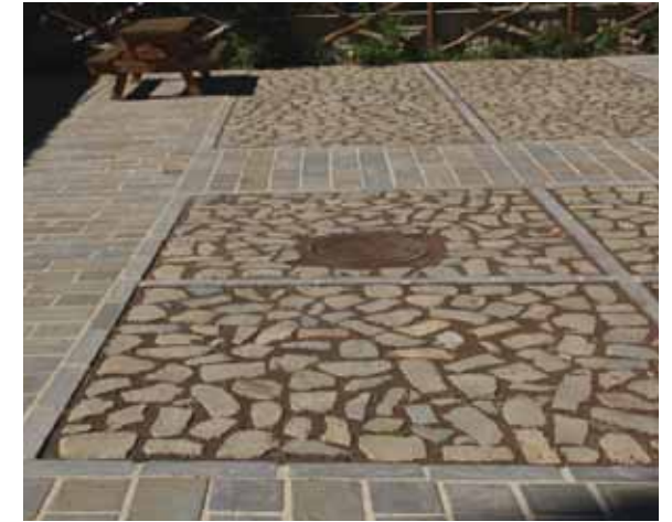
Fig. 94: No. Da evitare l'assemblaggio di materiali diversi non legati alle tradizioni locali.
