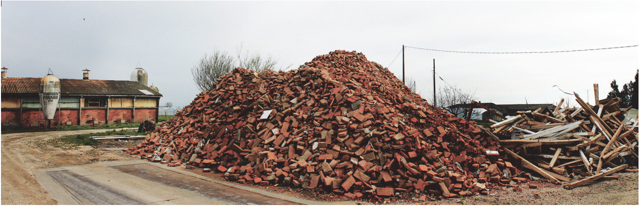
Foto 1. Le macerie della residenza, demolita in conseguenza dei danni riportati a causa del sisma.
