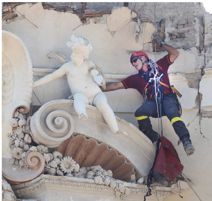
Frazione di San Carlo, Oratorio Ghisilieri, danneggiato dal sisma. Intervento dei Vigili del Fuoco per la messa in sicurezza dell'altare. fonte: https://fotoreporter.regione.emilia-romagna.it
