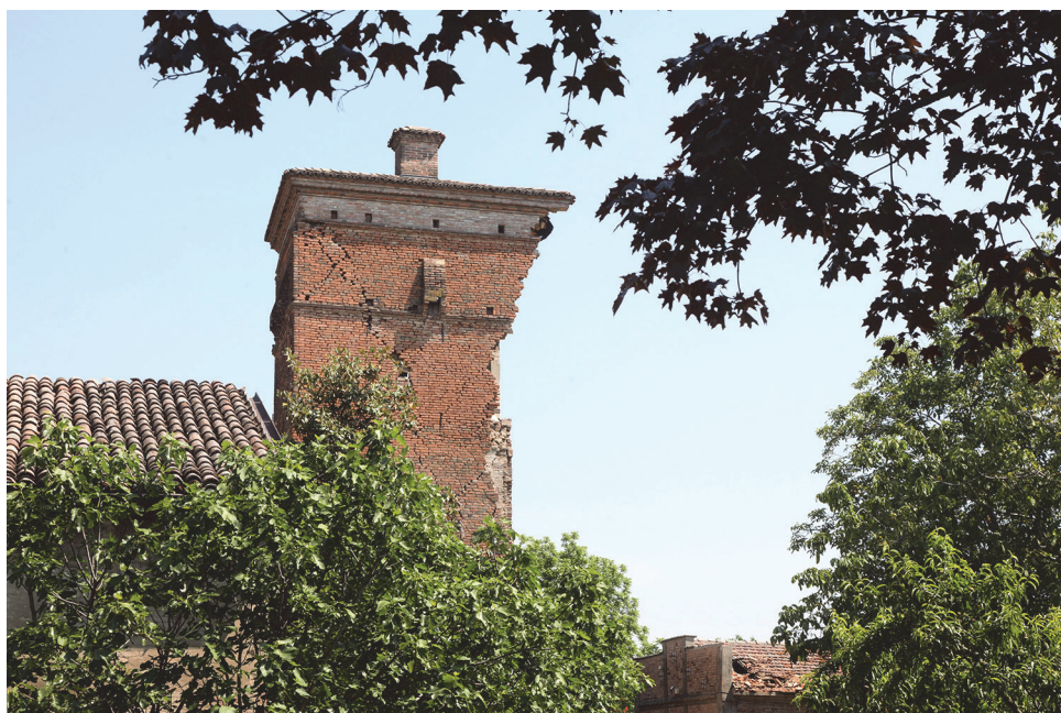
Malcantone, frazione di Medolla: parziale crollo della Torre Montecuccoli, eretta nel 1430. fonte: https://fotoreporter.regione.emilia-romagna.it
