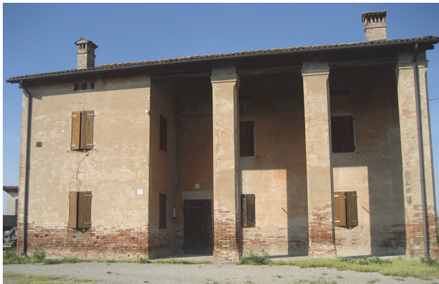
Casa padronale (foto post-sisma)
