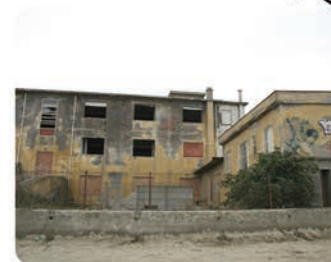
degrado e abbandono del patrimonio
