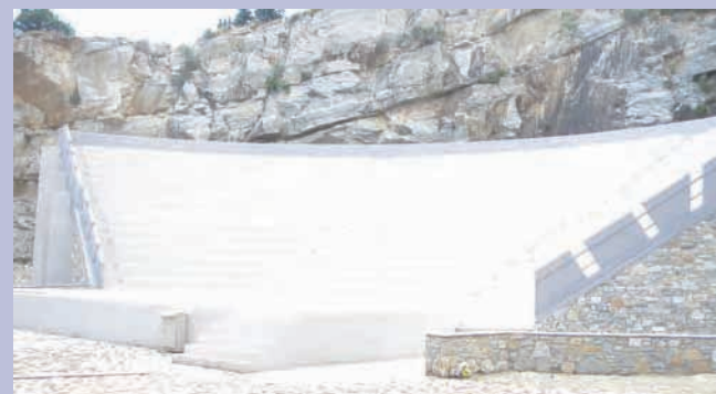
Άποψη του θεάτρου μετά την ολοκλήρωση του έργου The theatre after the project has been completed.
